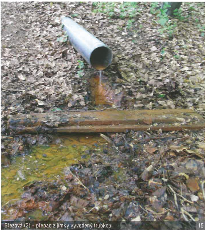
Březová (2) – přepad z jímky vyvedený trubkou
