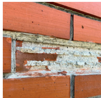
NUTNÁ OPRAVA. Fasáda byla na několika místech ve velmi špatném stavu.
