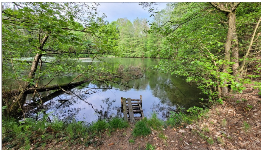
Obr. 4: Přírodní část hráze rybníka s malým rozpadajícím se molem; patrné jsou nálety zarostlé břehy.
