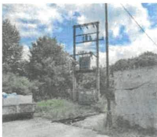
Obrázek 7. Vlastní transformační stanice
