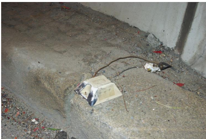
LAT – světlo poškozené provozem
